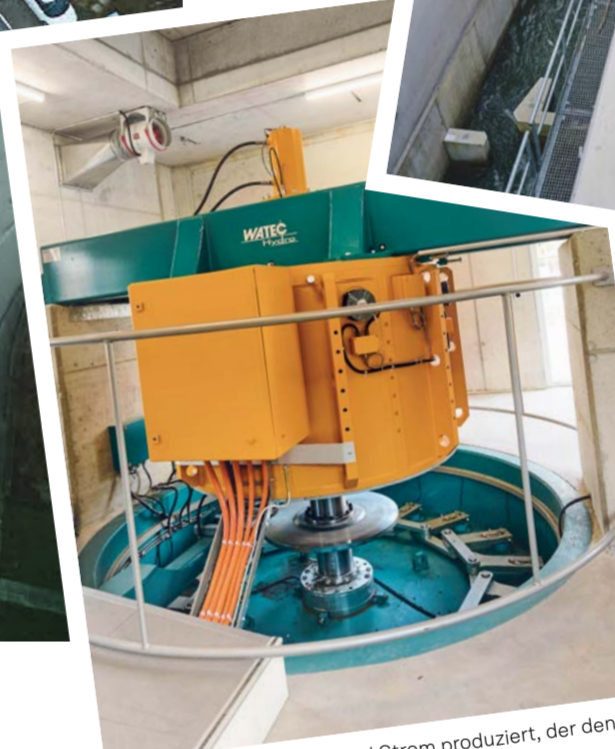
In diesem Turbinenraum wird Strom produziert, der den Jahresbedarf von 55 Haushaltungen deckt.
